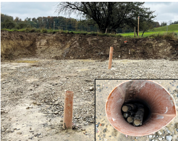
Nachhaltige Wärme liefert das Erdreich, dank insgesamt drei Erdsonden.
